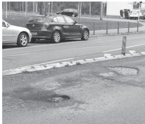
Gefährlich: Auf der Bolongarostraße ist der Asphalt gleich an mehreren Stellen mal beschädigt. Foto: Mingham
